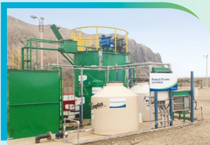
Planta de Tratamiento de Agua Doméstica (PTARD)
